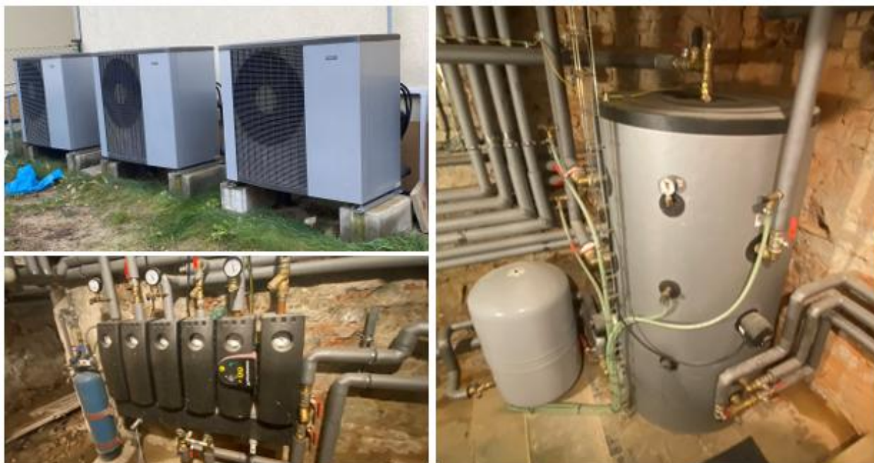
Obrázek 12 Tři tepelná čerpadla země - vzduch zásobující teplem budovu
